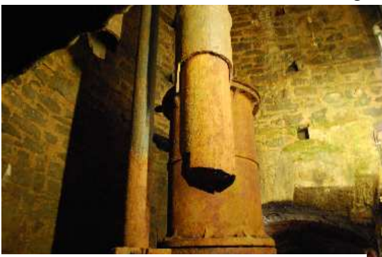
Zugesetztes Rohr der Wasserhaltungsanlage
